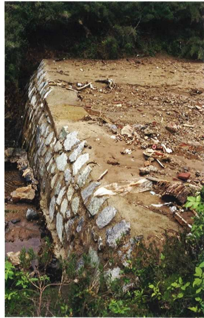
Fotografía 32. Dique de mampostería hidráulica colmatado en microcuenca Los Lúcumos, V Región Fuente: Patricio Novoa
