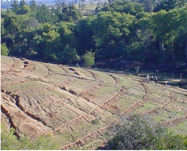
Fotografía 43. Líneas de microterrazas y batería de zanjas de infiltración. Lagunillas, VI Región
