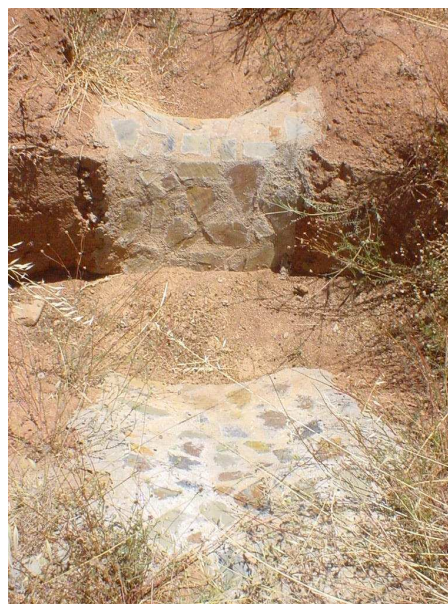
Fotografía 68. Punto de evacuación de canal de desviación revestido de piedra y cemento en Coelemu, VIII Región
