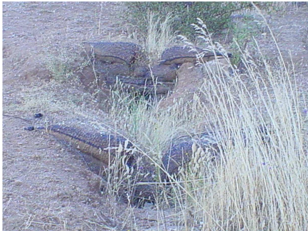
Fotografía 11. Canal de desviación revestido con sacos con arena. Cuesta Cavilolén, IV Región
