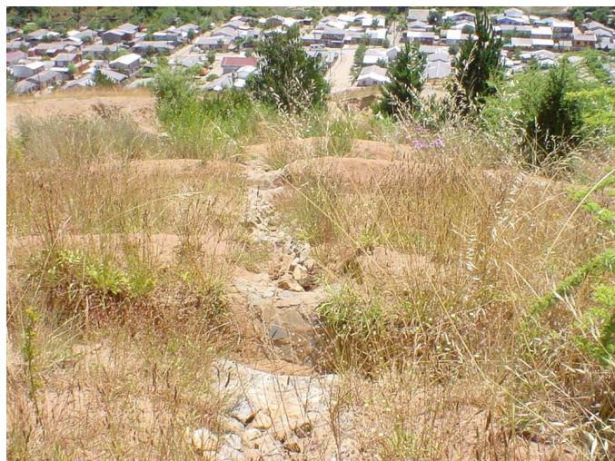
Fotografía 67. Canales de desviación con revestimiento de piedra y cemento en los puntos de evacuación Coelemu, VIII Región
