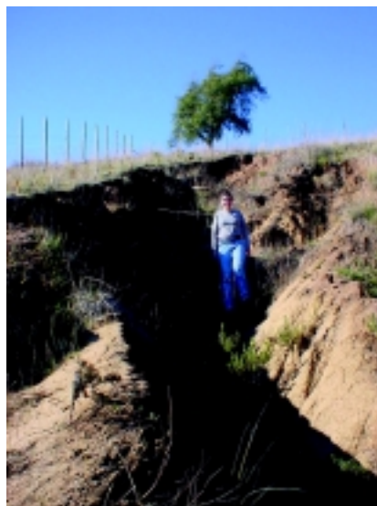
Fotografía 6. Vista al interior de una cárcava, Paredones, VII Región
