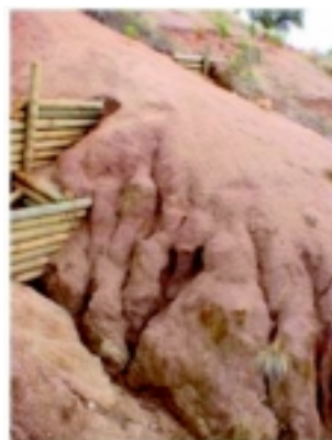
Fotografía 27. Taludes inestables aguas abajo del dique
