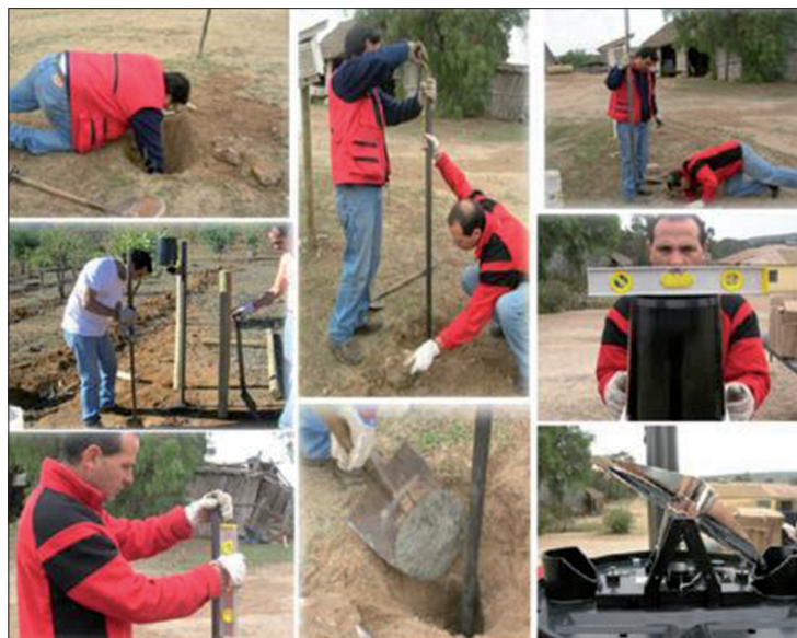
Figura 16. Procedimiento de instalación de los pluviógrafos. Gentileza de Estándares de ingenierías para aguas y suelos (EIAS, 2007).
