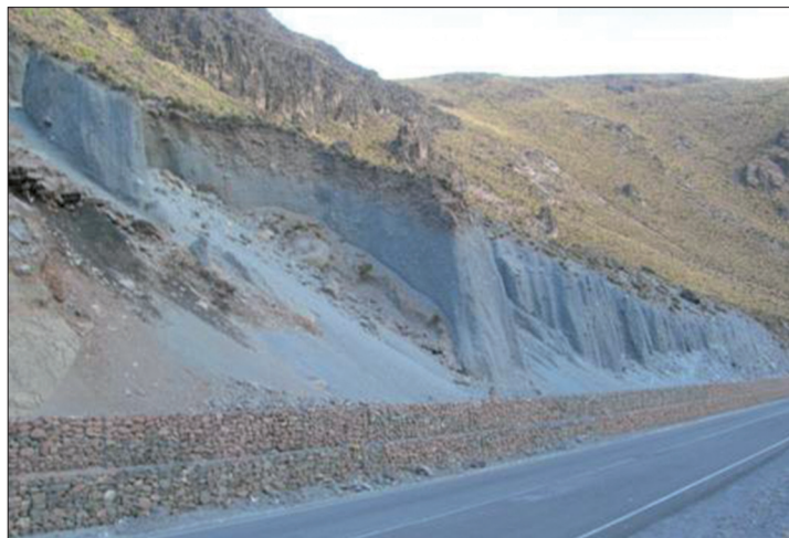
Figura 5: La presencia de cárcavas y desprendimientos, obliga al uso de obras civiles para la defensa de la infraestructura. Fotografía tomada por Roberto Pizarro.
