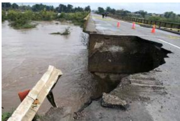
Figura 2.1. Colapso del puente Batuquito en la ruta 5 sur, región del Bío-Bío, año 2006. Fuente: Ing. Jaime Rodríguez, CMPC.
