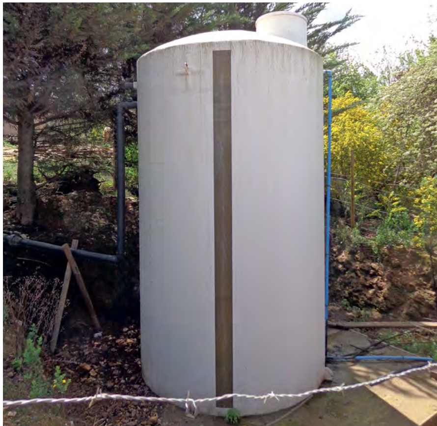
Figura 12. Estanque de fibra de vidrio con capacidad de 20 m 3 en el sector de Ramadillas, Pelluhue, Región del Maule.
