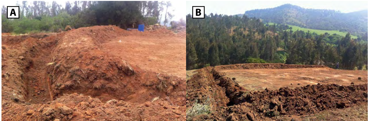
Figura 28. Excavación de canaletas para sujeción de la geomembrana en la Reserva Nacional Lago Peñuelas (A) y en El Leoncito (B).
