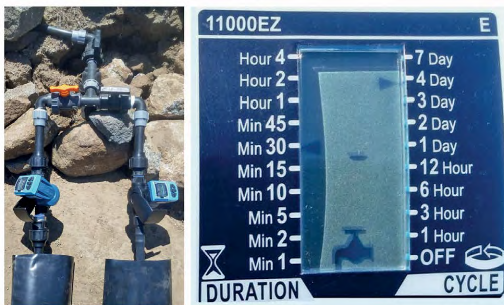
Figura 50. Controladores de válvulas instaladas en terreno y detalle de la pantalla, programada para regar durante 30 minutos cada 4 días, en esta primera etapa.
